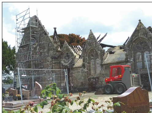
L'église après l'incendie
